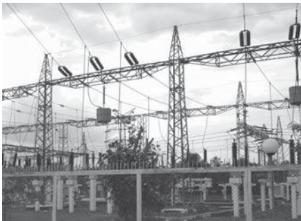
(a) Kabel Listrik
